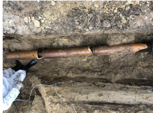
Foto 23: meerdere gebroken mofverbindingen
